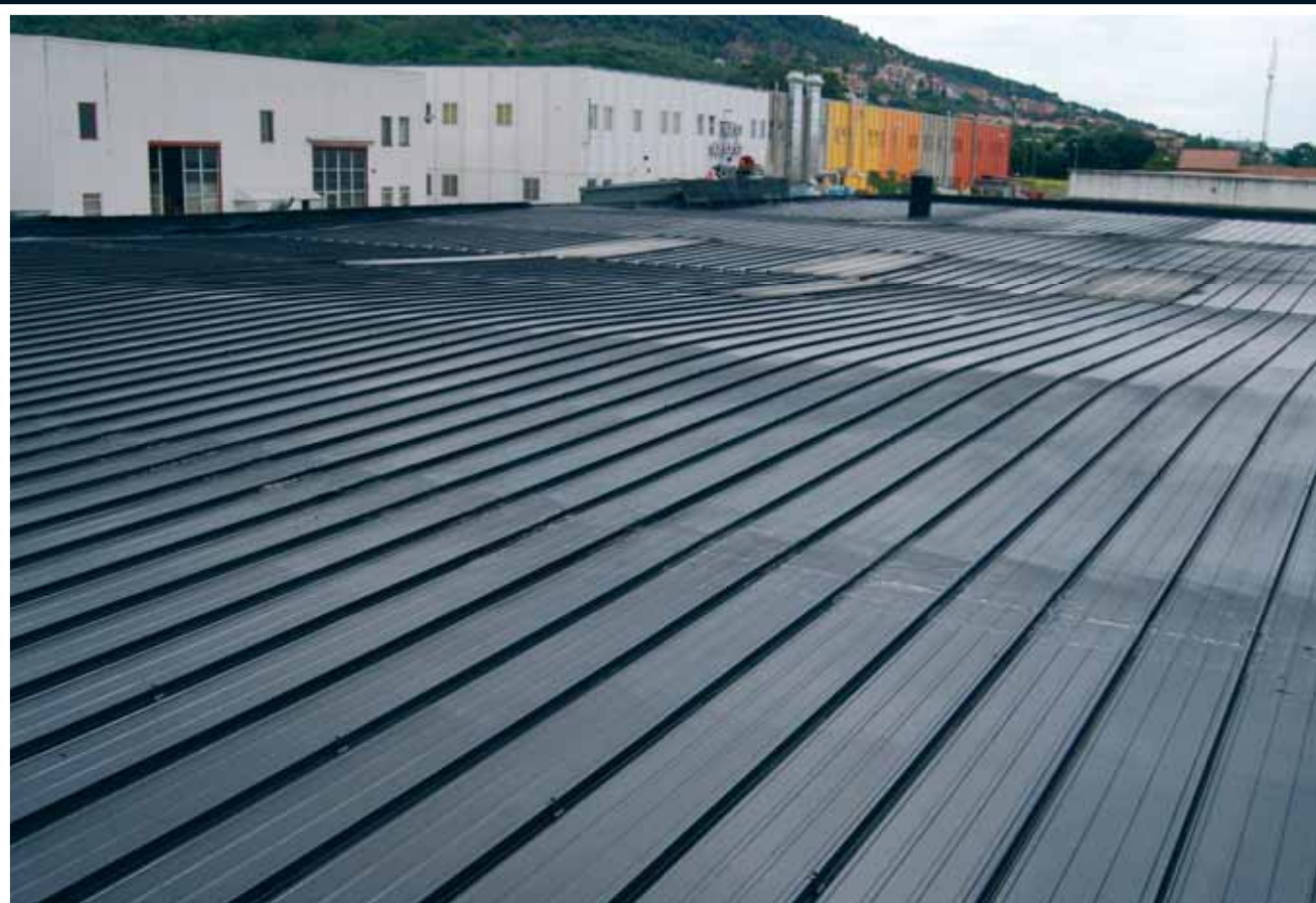
Aspetto della copertura metallica dopo il trattamento realizzato con due mani di ElastiK stese a distanza di 48 ore una dall'altra (applicazione a spruzzo con un consumo totale di 1 kg/m 2 )
