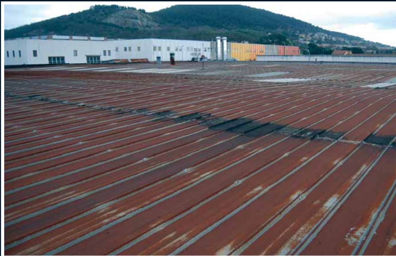
Condizioni della copertura metallica di circa 7.000 m 2 prima dell'intervento di ripristino
